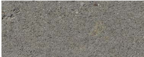
Balkon ohne Abdichtungsbahn
