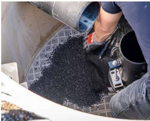
Installation du filtre technique
