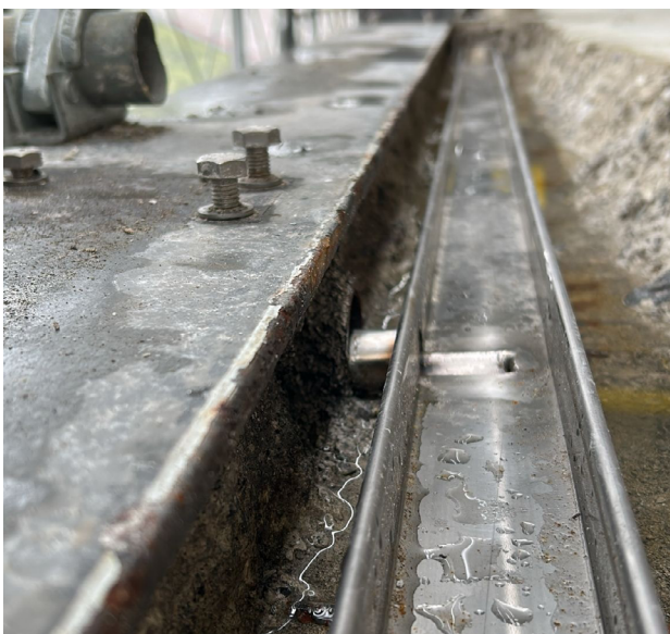
Seitlicher Abfluss der Balkonrinnen für eine kontrollierte Wasserführung
