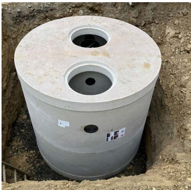
Installazione dell'impianto compatto
