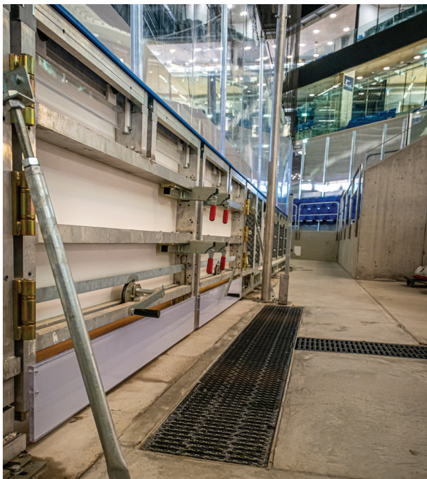
Les solutions de drainage ACO Drain autour de la patinoire
