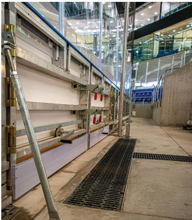
Le soluzioni di drenaggio ACO Drain per il campo di ghiaccio
