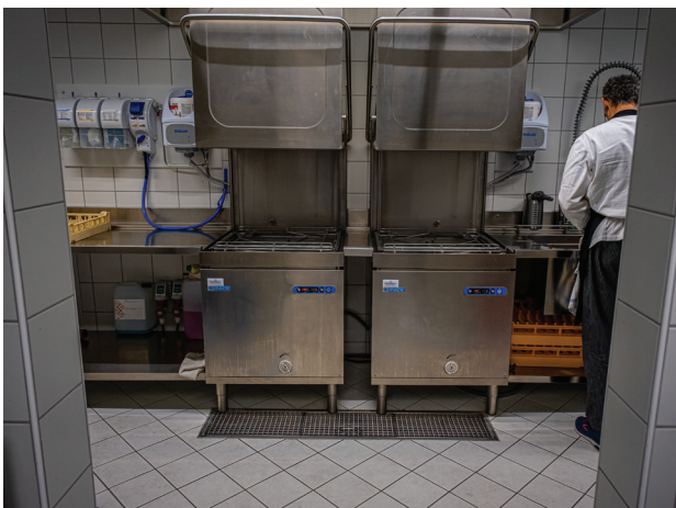
Gli innovativi canali di scarico ACO garantiscono i più elevati standard di igiene e sicurezza nella cucina dello stadio.
