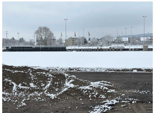
Die ACO Produkte sind vollständig angeliefert und einsatzbereit auf dem Lagerplatz.
