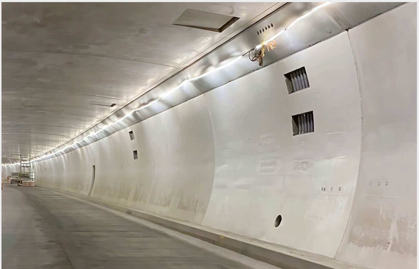
ACO Randsteine im Gubristtunnel.
