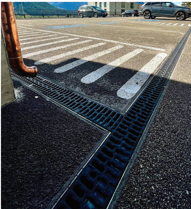
I canali ACO AHR completamente installati
