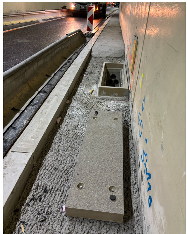
ACO Kabelschacht im Tunnel Schoren
