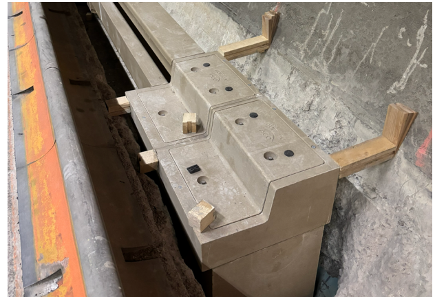
ACO Siphonschacht im Tunnel Rosenberg
