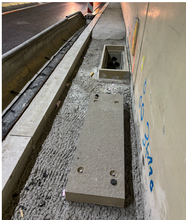
Regard de câbles ACO dans le tunnel de Schoren
