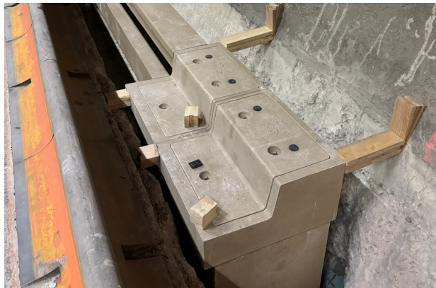
Regard de siphon ACO dans le tunnel de Rosenberg
