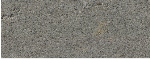
Balcon sans membrane d'étanchéité
