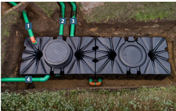
Exemple de construction d'un réservoir d'eau de pluie de 4.000 l avec utilisation comme rétention et stockage d'eau de pluie
