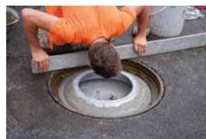
Couler le cadre, éliminer 3 mm du revêtement de la chaussée par martèlement
