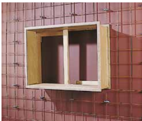
Placer la latte inférieure / le battement pour protéger de la contre-pression et sécuriser le cadre de l'ouverture d'homme à l'aide d'un latte vertical pour qu'il ne fléchisse pas.
