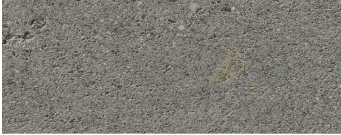
Balkon ohne Abdichtungsbahn
