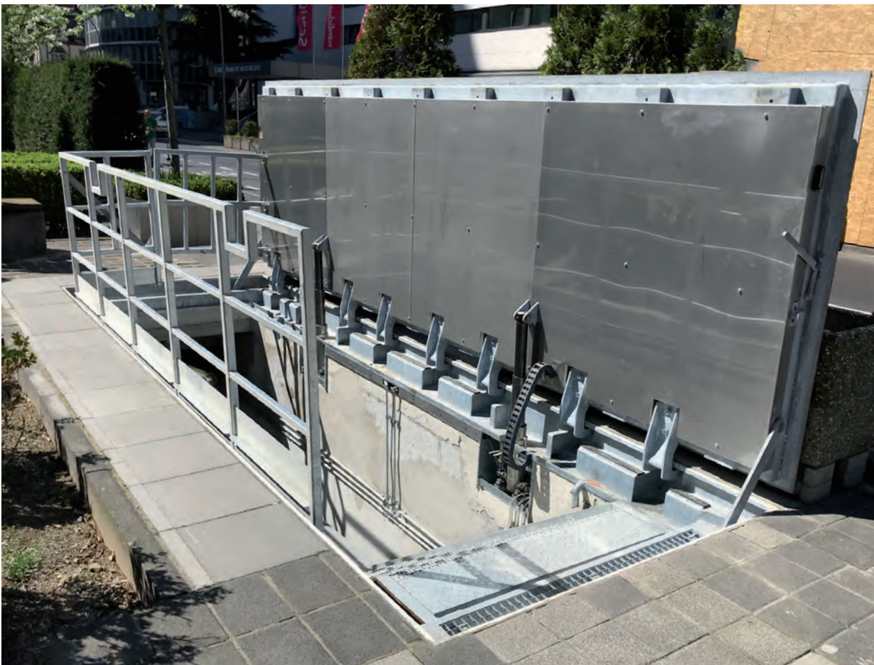
Uscita scala con pannelli di protezione antincendio e lamiera di protezione.
