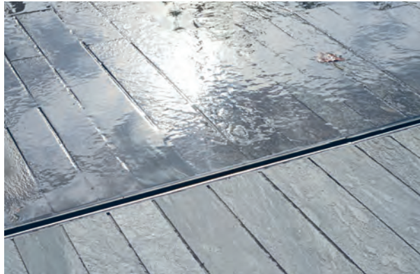
Canaletti a fessura in acciaio inox
