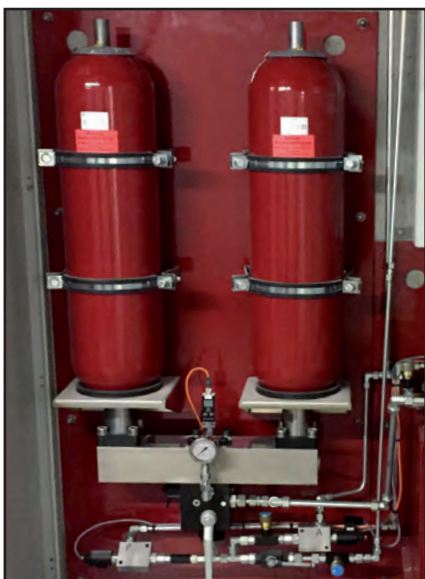
Accumulatore di pressione per l'apertura di emergenza in caso di mancanza di corrente elettrica
