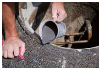
Sistemare le fessure fra il telaio e lo strato di copertura
