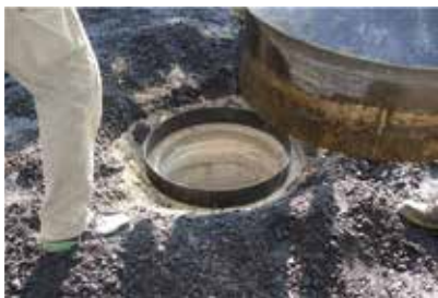
Mettere il chiusino per pozzetto allo scoperto, togliere la lamiera di acciaio, collocare l'anello guida
