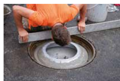
Procedere con colatura sotto il telaio e incorporare uno strato di copertura a 3 mm di profondità
